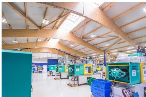
Dreiflämmige LED-Hallendeckenstrahler beleuchten die Halle im neuen Werk optimal
